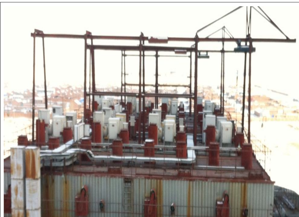
改造前除尘设备
