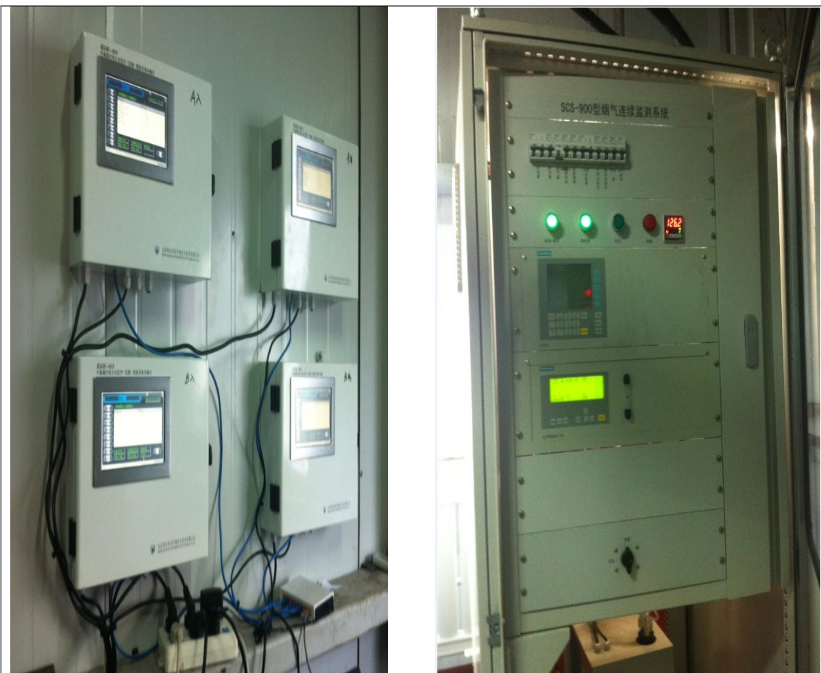
脱硝装有四台连续监测仪
