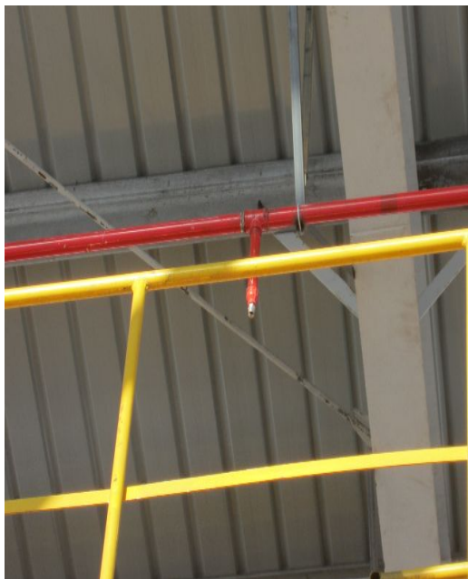
液氨储罐喷淋装置
