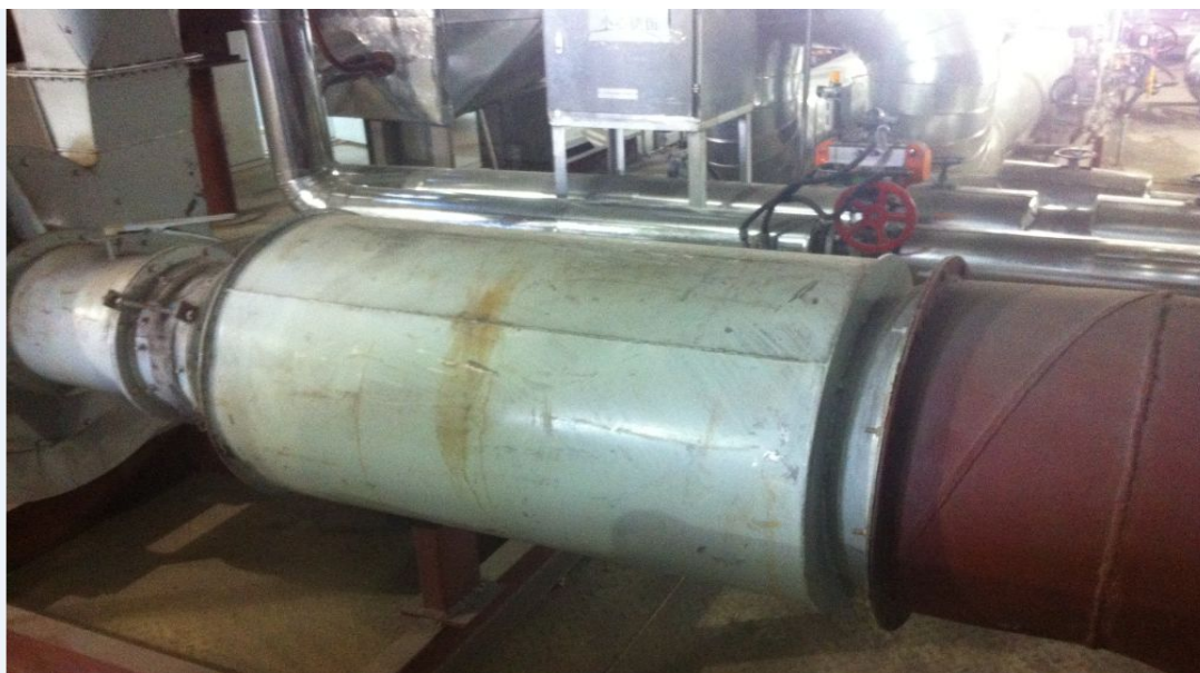
装有降噪设备的泵类
