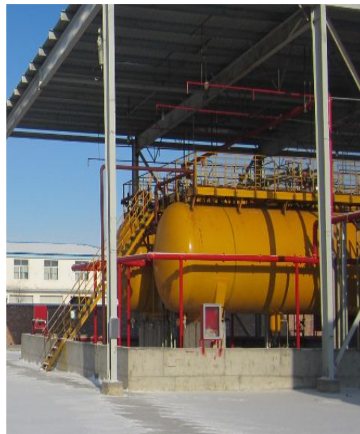
液氨储罐围堰
