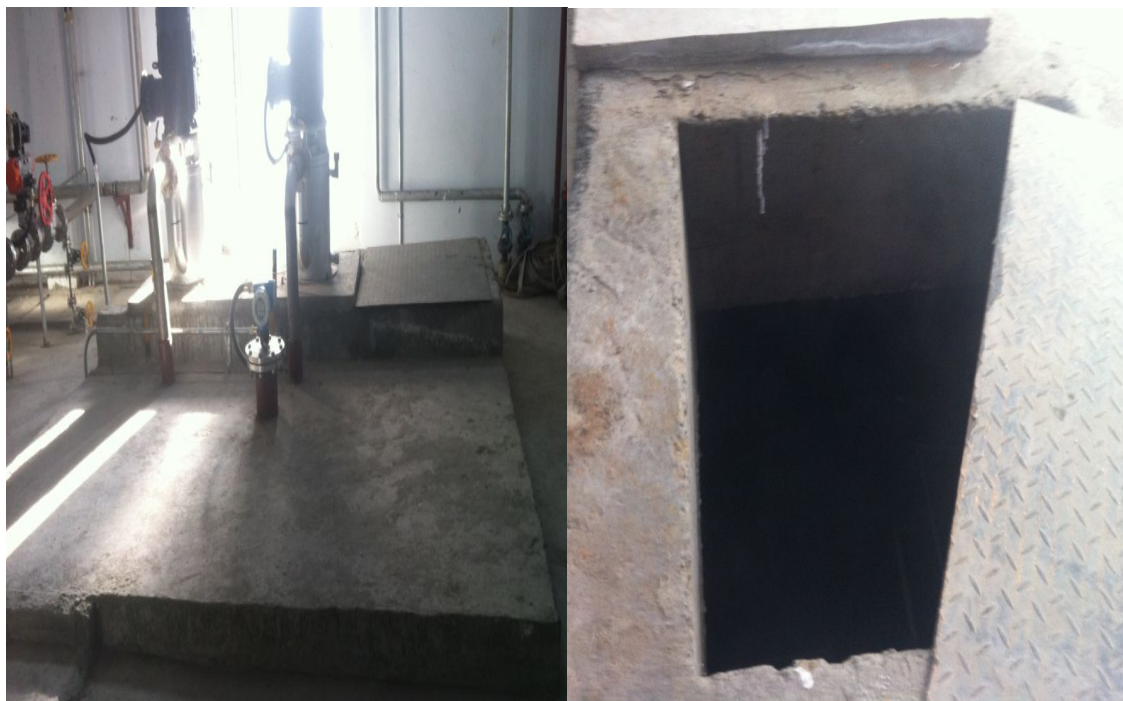
原剂制备车间收集废水管道
