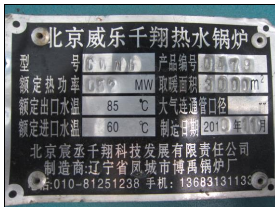
额吉淖尔站环线供热锅炉铭牌
