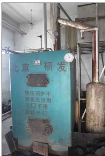
额吉淖尔环线锅炉
