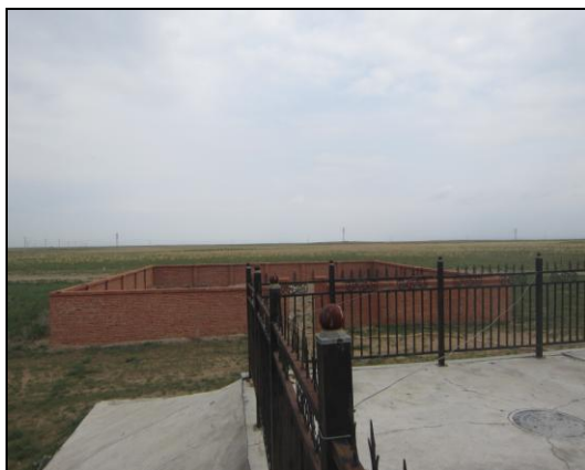
额吉淖尔站垃圾储存池
