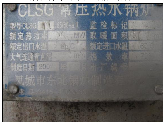
额吉淖尔站环线热水锅炉铭牌
