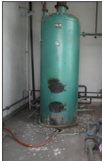
乌珠穆沁站供热锅炉
