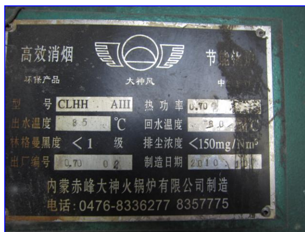
乌尼特环线锅炉铭牌
