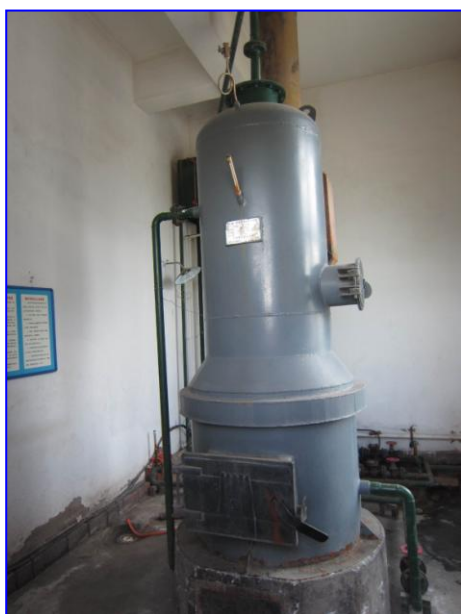
乌尼特站供热锅炉
