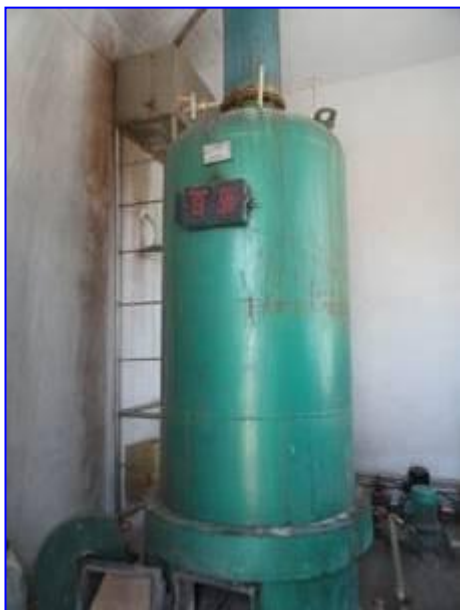
道特诺尔站供热锅炉
