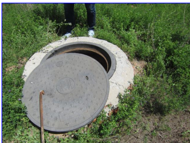
道特诺尔站污水沉淀池
