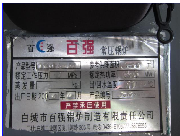
道特诺尔站供热锅炉铭牌
