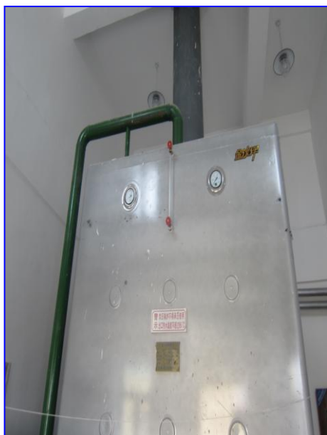
宝力格站供热锅炉
