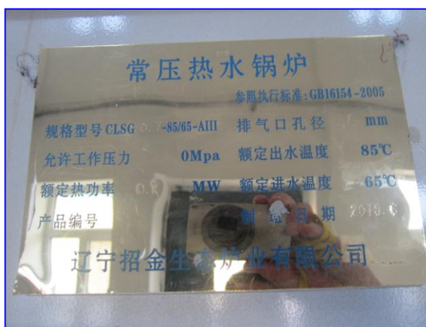
宝力格站供热锅炉铭牌
