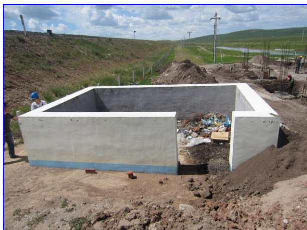
道特诺尔站垃圾收集池
