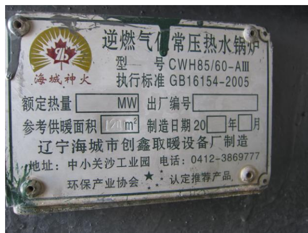
巴彦胡硕站供热锅炉铭牌
