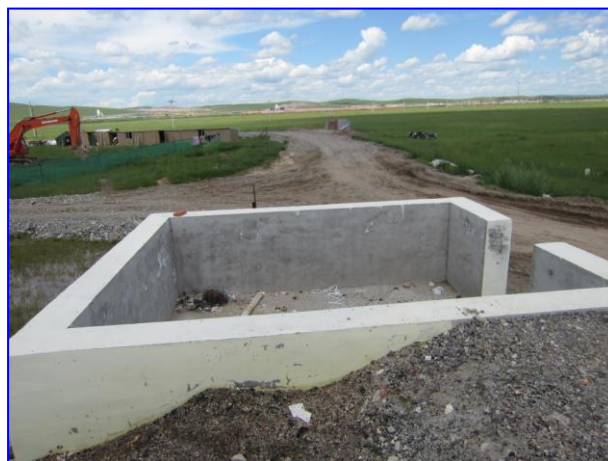
巴颜胡硕站垃圾收集池
