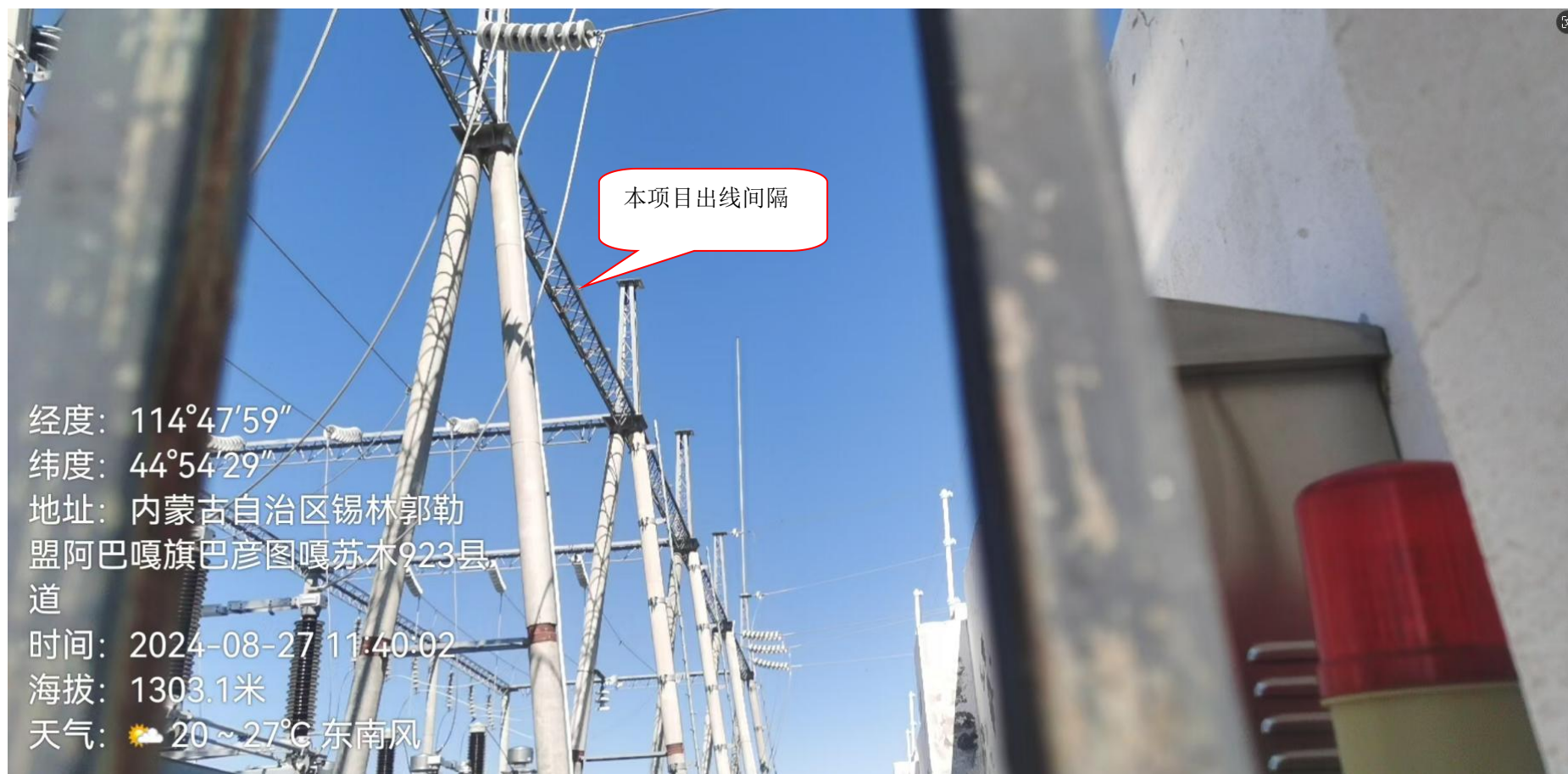
图 26 白音图嘎 110kV 变电站本项目出线间隔位置
