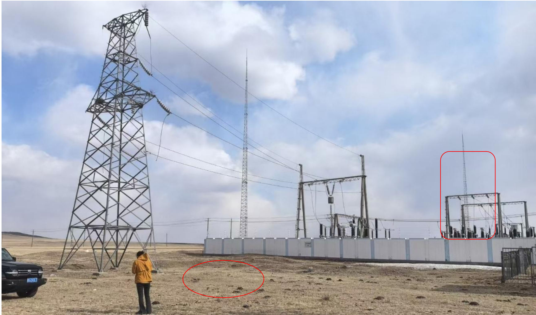
图 2-11 德力格尔 110kV 变电站本期扩建间隔位置（红色方框内）、第一基塔位置（红色椭圆内）
