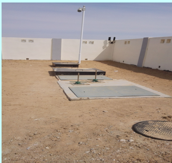
污水处理系统
