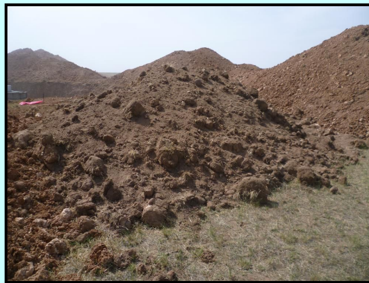
挖方无拦挡及苫盖措施
