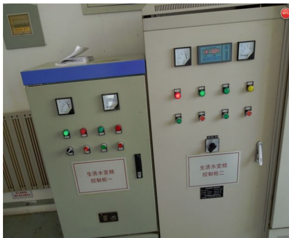
消防用水和生活用水变频控制柜
