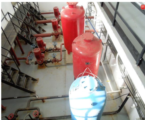
地下水和消防用水处理系统
