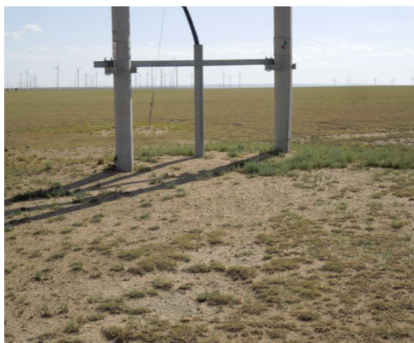
一期恢复较好的线杆
