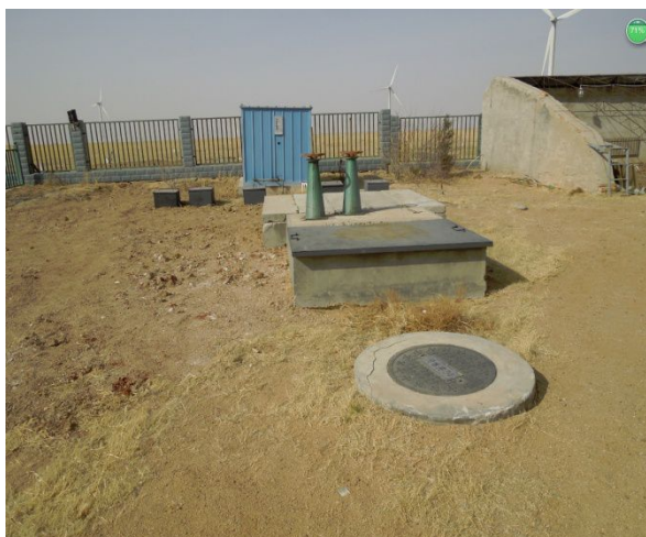
生活污水一体化处理设施
