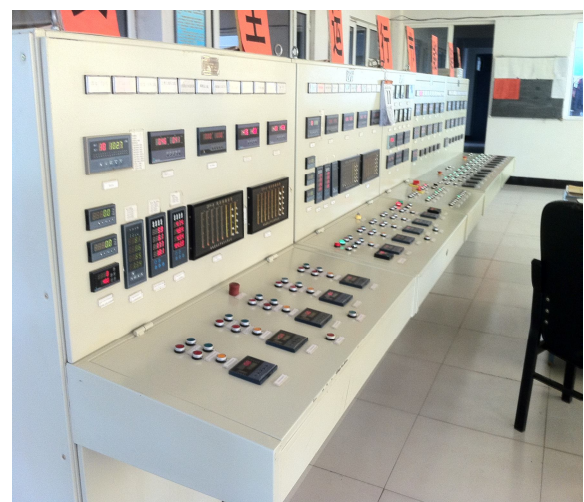
锅炉房微机室
