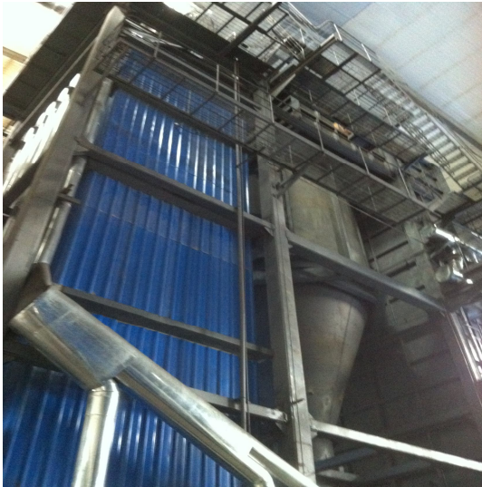
循环流化床锅炉
