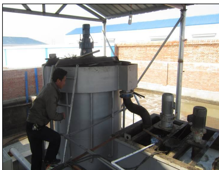
污水处理系统的气浮机
