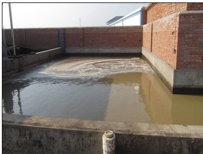
污水处理系统污泥沉砂池
