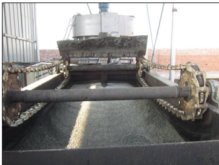
污水处理系统的生化反应池
