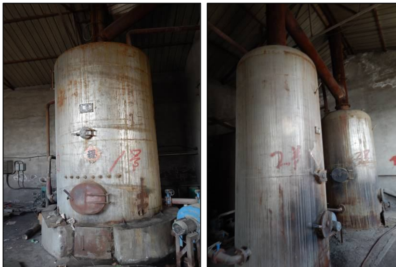
项目供热锅炉
