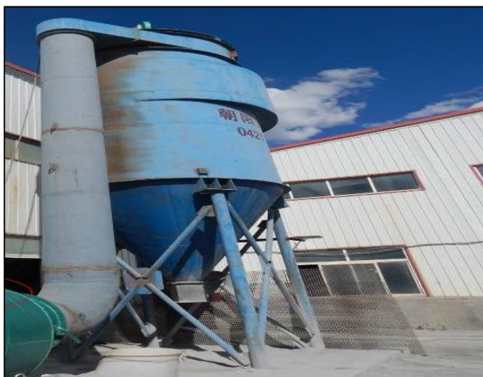
破碎间除尘器
