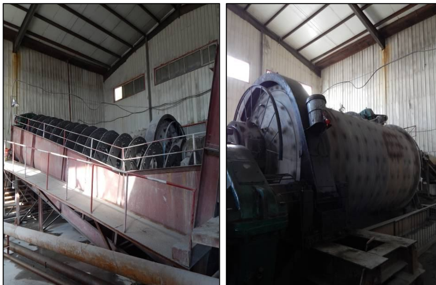
高噪声设备安装在室内
