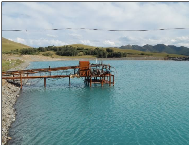
尾矿库回水泵及回水管道
