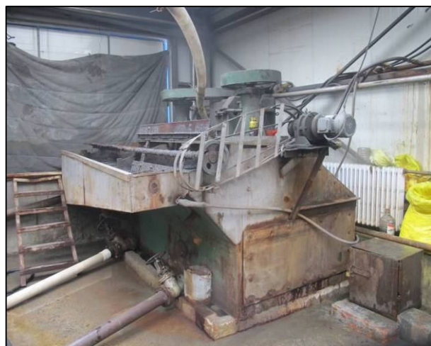
浮选机安装在车间内
