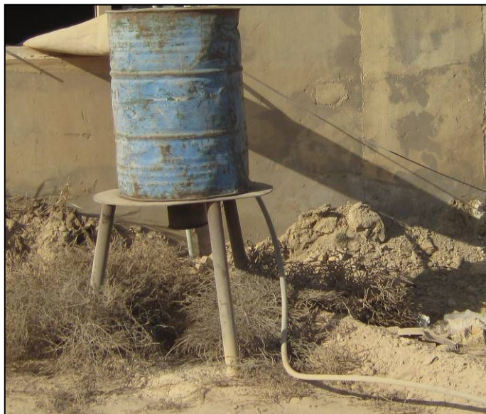
除尘器收集的粉尘外排（整改前）
