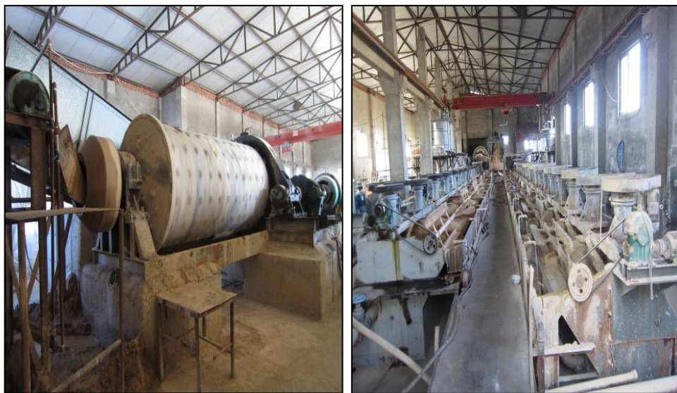
高噪声设备安装在室内
