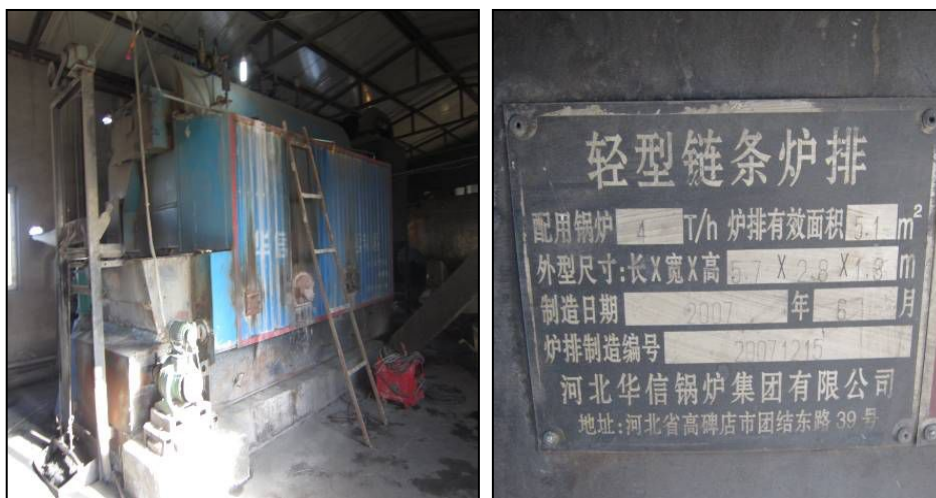
生产用锅炉及铭牌
