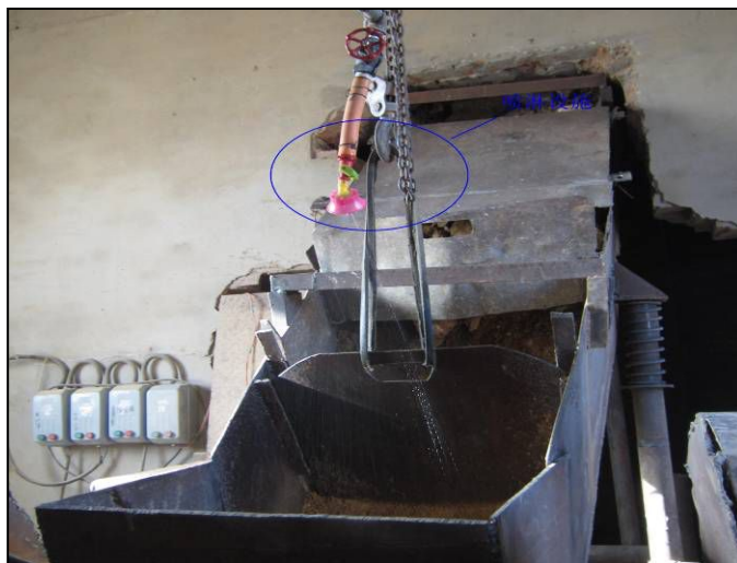
落料口的喷淋设施
