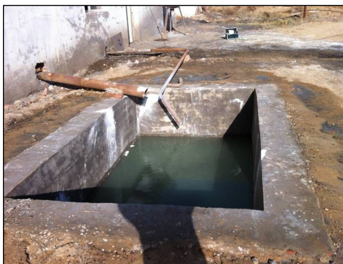
脱硫废水沉淀池
