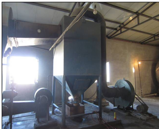
锅炉脱硫除尘器
