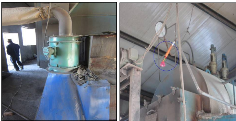
进煤口的自制除尘器 and 洒水喷淋设施
