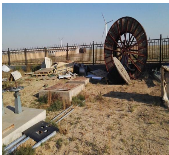
光伏板已清理
