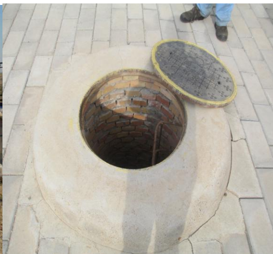
原有升压站内事故油池
