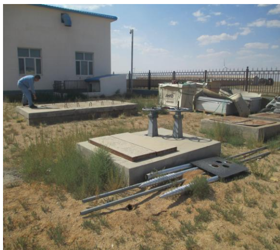
站区地埋式一体化
