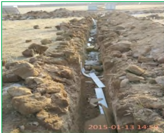
施工垃圾乱扔乱弃
