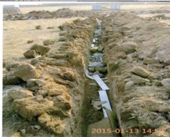
施工垃圾乱扔乱弃
