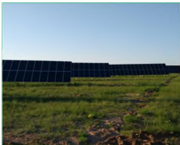
光伏电场近景
