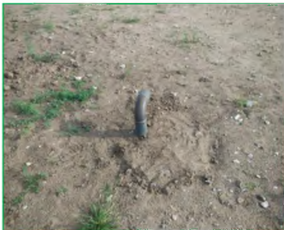
事故油池排气口
