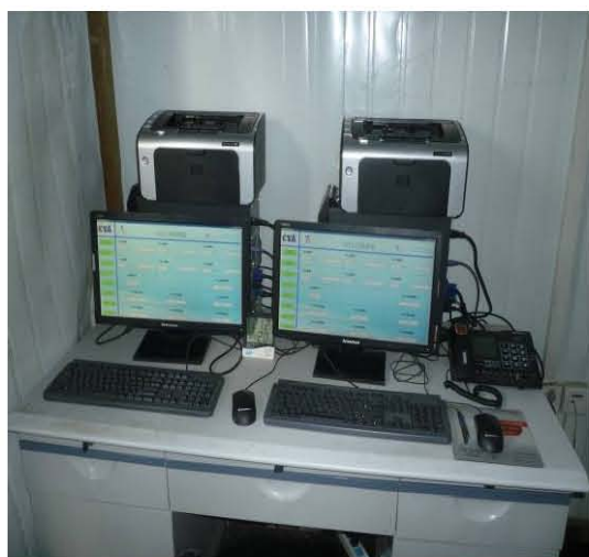
脱硝进、出口在线监测系统
