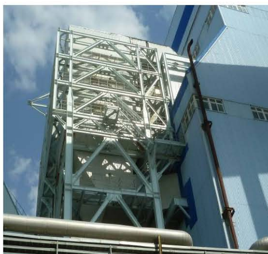
SCR 脱硝装置
