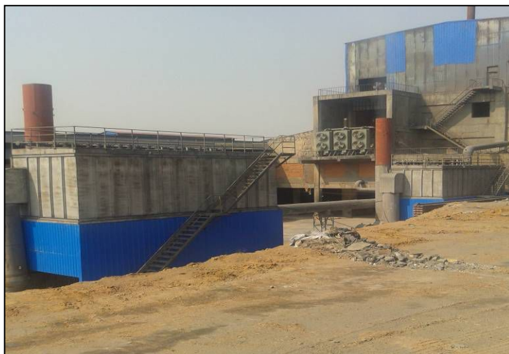
处理电石炉出料口废气的除尘器
