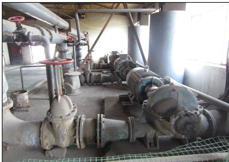
泵类安装在封闭车间内
