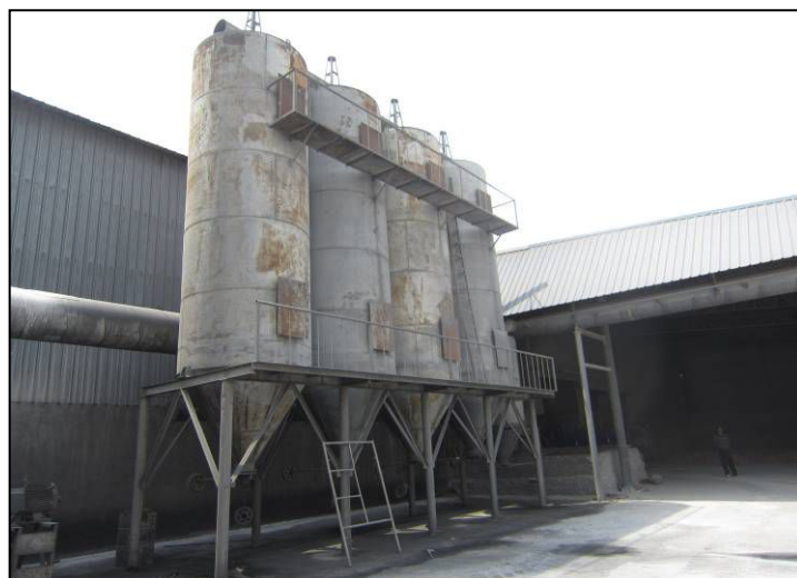
配料站的除尘器
