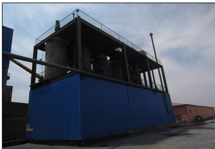
电石炉炉气净化除尘器
