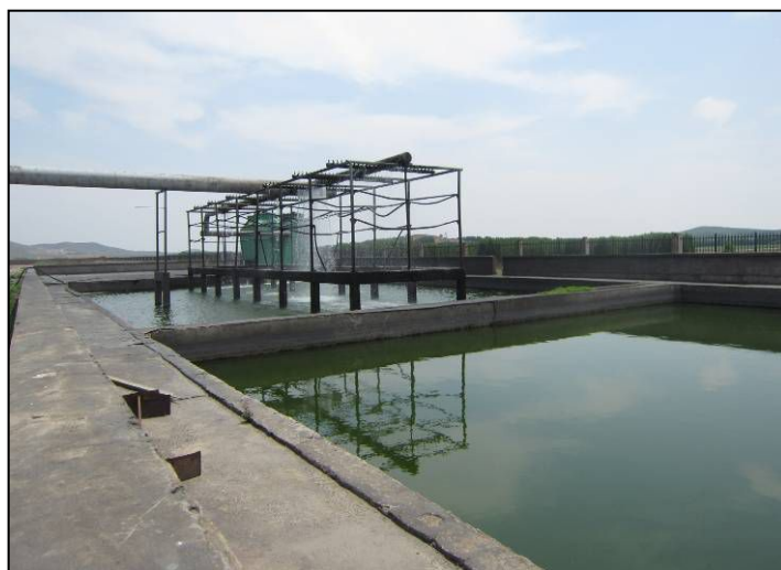
冷凝塔及循环水池
