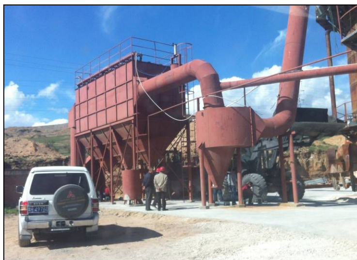
石灰窑窑气除尘器
