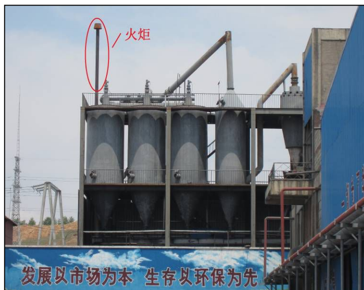
炉气应急燃烧的火炬
