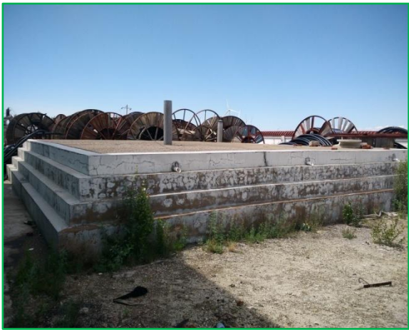
生活污水收集池
